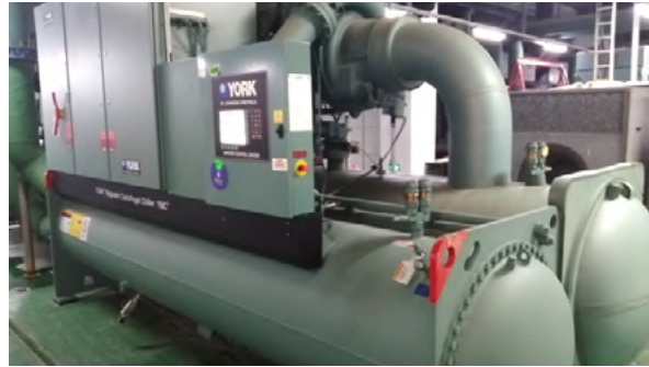
磁悬浮冰机节能改造项目
