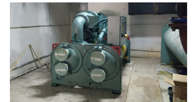
螺杆机热泵项目
