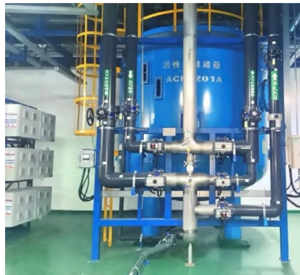
臭氧废水回收处理系统
